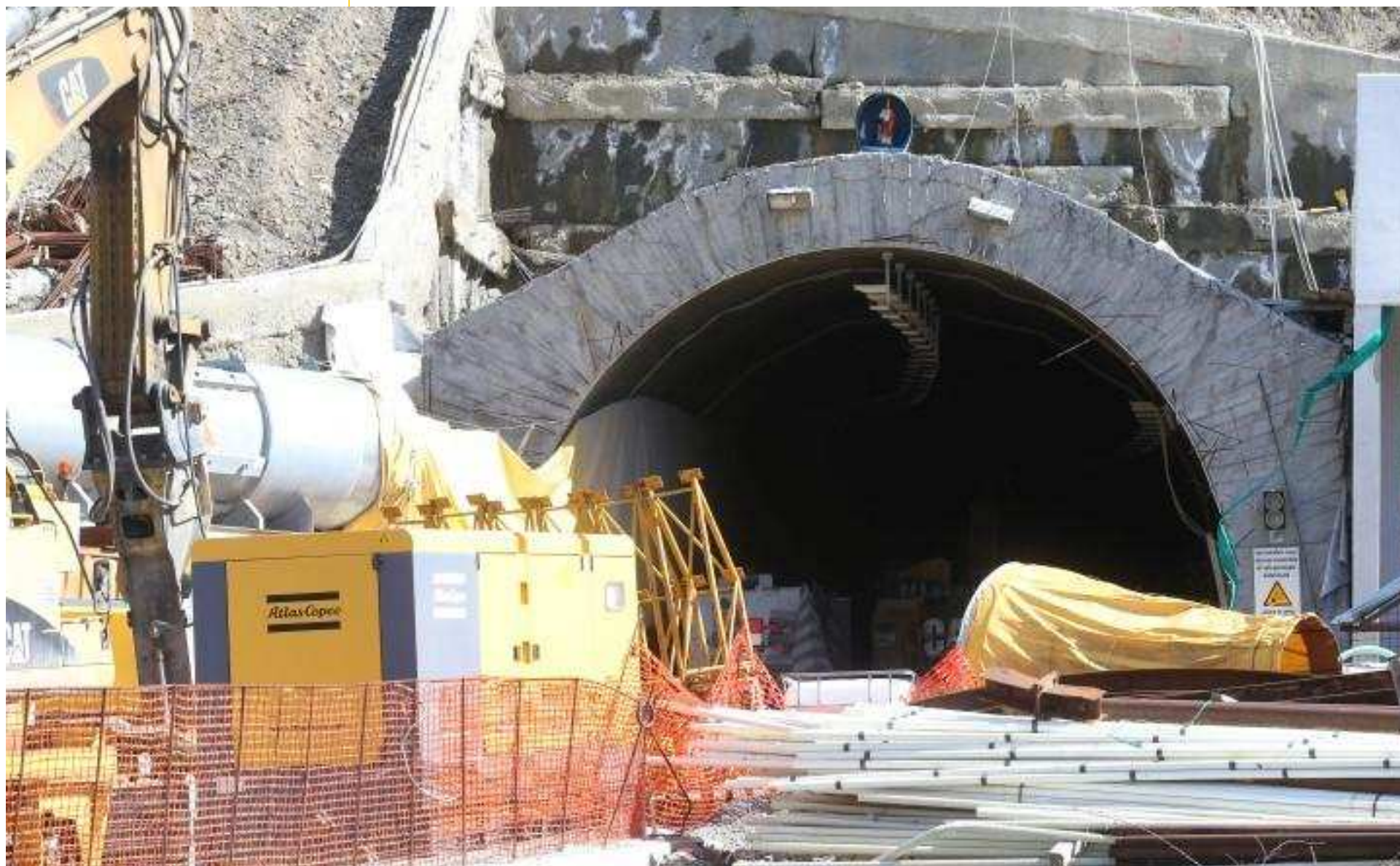
Ce scandale a considérablement retardé la livraison du nouveau tunnel, espéré au mieux en 2023, au lieu de 2020. Photo Cyril Dodergny
